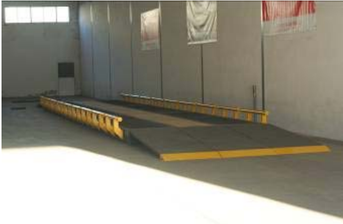
Báscula Puente PCM SG metálica sobresuelo, con rampas metálicas
