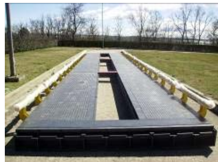
Báscula puente PCM SG sobresuelo construida con módulos metálicos.
