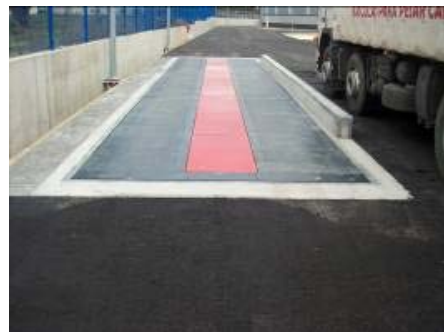
Báscula puente PCM SG empotrada construida con módulos metálicos.
