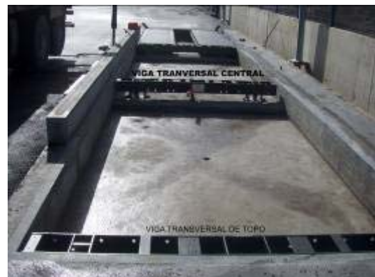
Vigas transversales de testeros y centrales montadas y preparadas para ser instalados los módulos.
